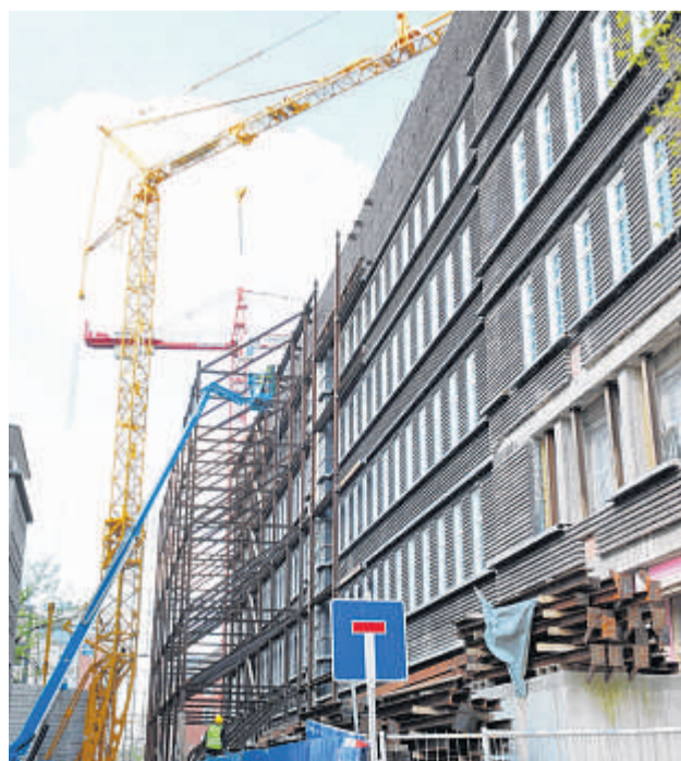
Das stählerne Stützkorsett wird an der Fassade abgebaut. Einige Etagen haben bereits die neuen Fenster. Foto: Olaf Fuhrmann
